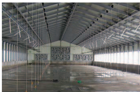
Фото 1. Вентиляторы, обеспечивающие скорость воздушного потока 2 м/с
