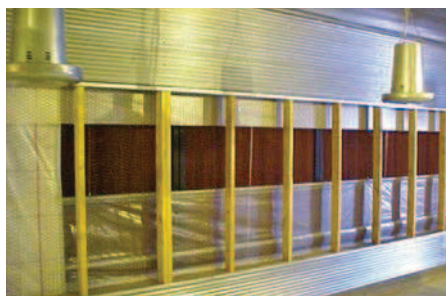
Фото 2. Клапаны тоннельной вентиляции и внутренняя сторона охладителей испарительного типа
