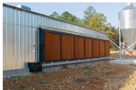
Фото 3. Насадки в системе испарительного охлаждения, закрывающие воздухозаборные клапаны
